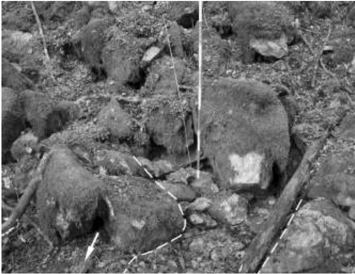
図7 風穴の吹き出し口 B3 付近 破線の間の部分で落葉と土壌が流亡し、矢印部分で砂が流出（図8）していた。
